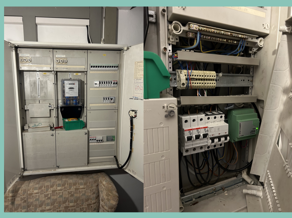
Zustand der Elektronik im Keller wurde begutachtet (Platz im Zählerschrank und für Kabelwege erkundet)
